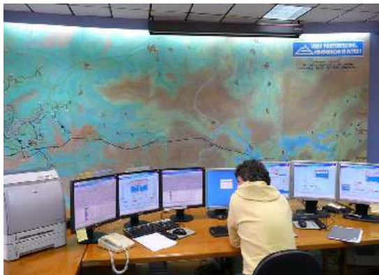
Control telemático. Red de Abastecimiento del Consorcio de Aguas de Bilbao Bizkaia (CABB)
